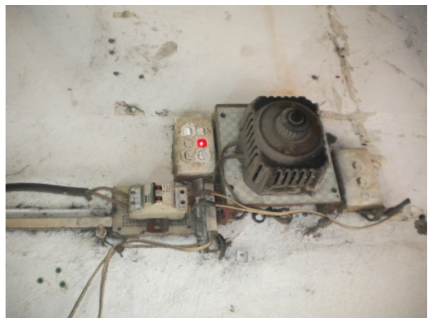
Stromanschluss im Einzelhandel in Hanoi. Electrical connection in a retail shop in Hanoi.
