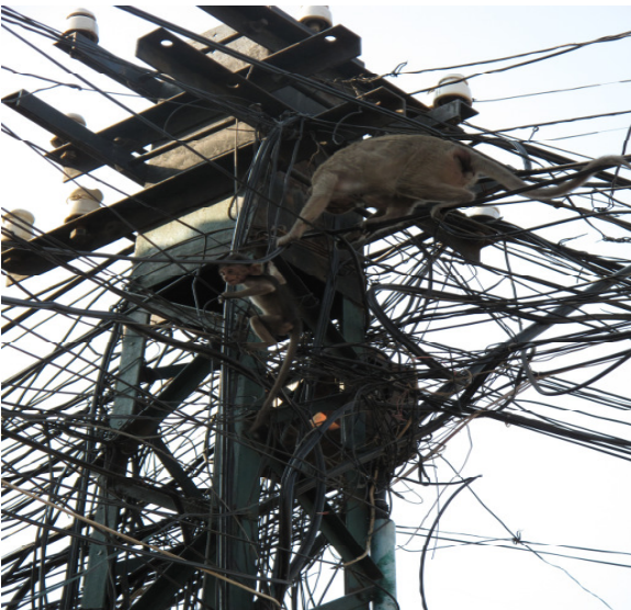
Stromversorgung auf Vietnamesisch. Vietnamese way of electrical power supply.
